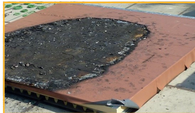
Bild 5 | PU-Dach – verbrannte Fläche nach Entfernen der PV-Elemente
