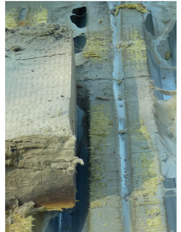
Bild 14 | Brandschädigung der verschiedenen Schichten des Dachaufbaus
