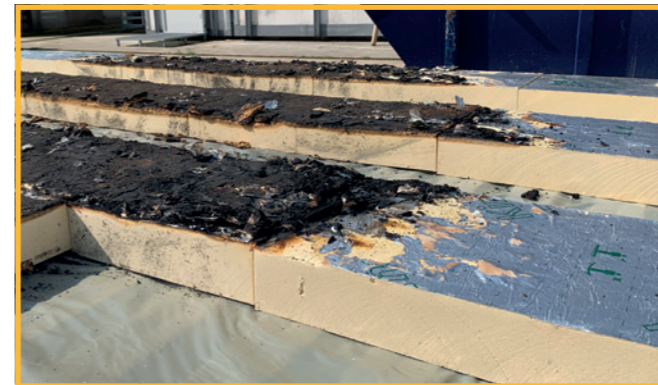
Bild 13 | Brandschädigung der verschiedenen Schichten des Dachaufbaus
