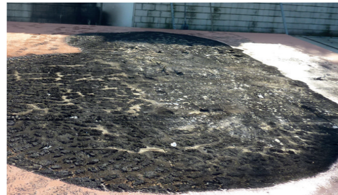
Bild 6 | MW-Dach – verbrannte Fläche nach Entfernen der PV-Elemente
