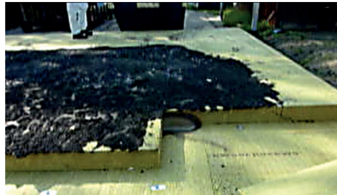
Bild 10 | MW-Dach – Schädigung der Dämmschicht
